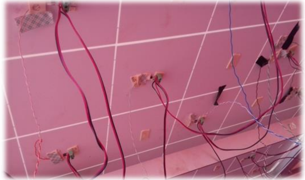
Vista interior de los sensores de temperatura en el módulo fotovoltaico
